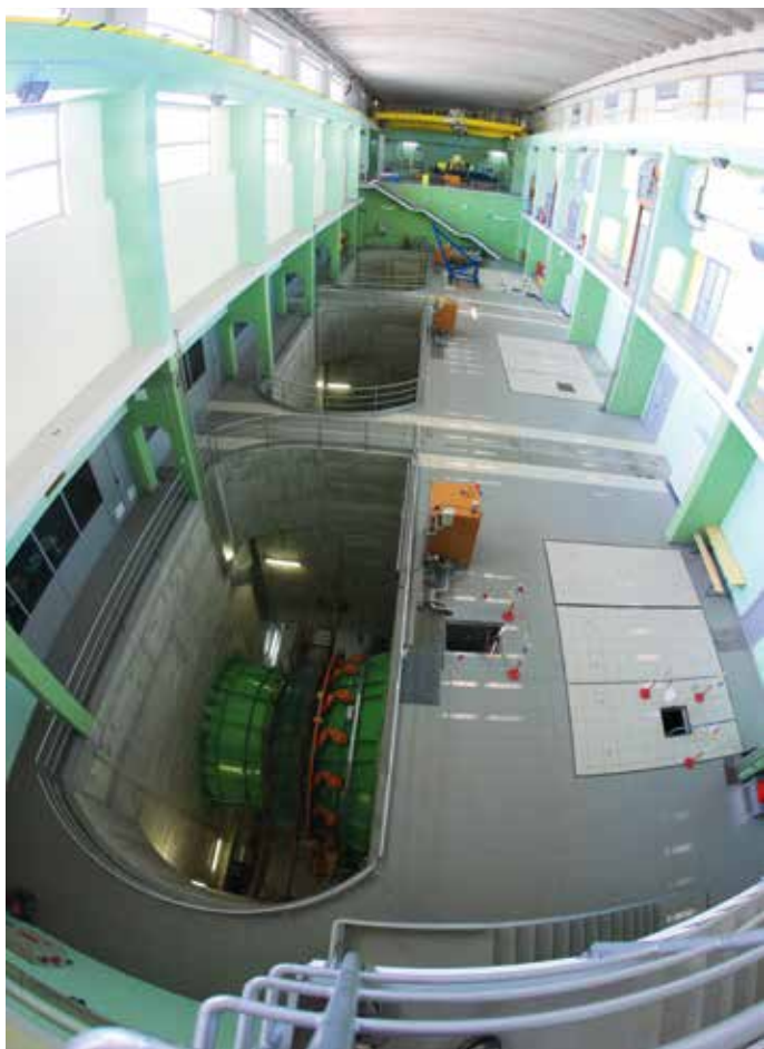
Strojnica HE Boštanj; foto: Arhiv HESS
