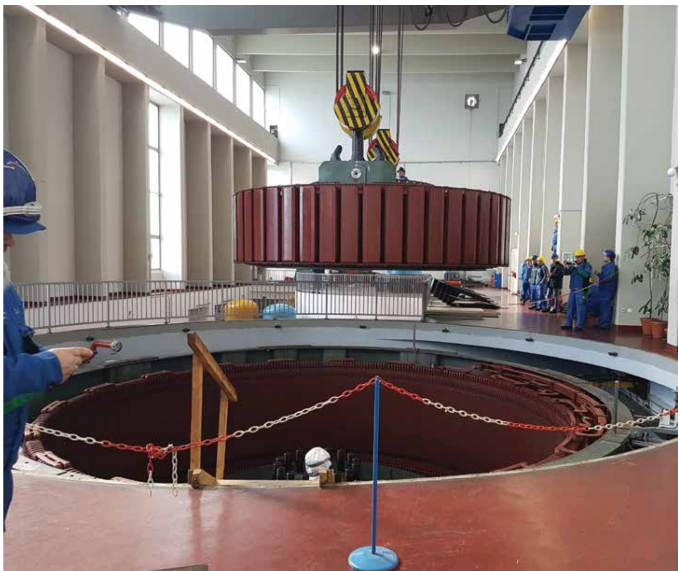
Notranjost hidroelektrarne Formin. Foto: Arhiv DEM
