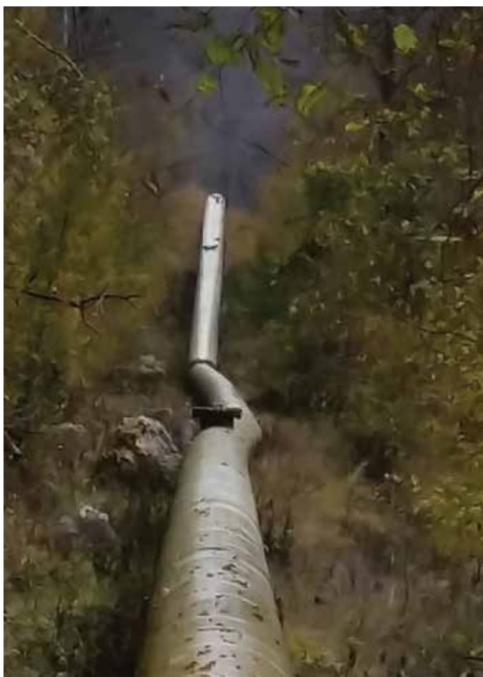
Poškodba cevovoda; foto: Arhiv SENG
