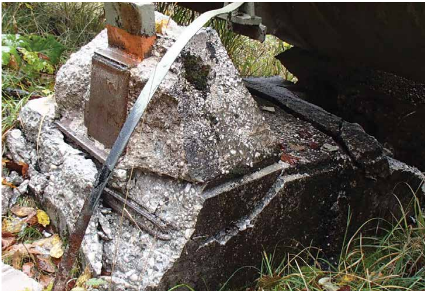
Poškodovani temelji cevovoda; foto: Arhiv SENG
