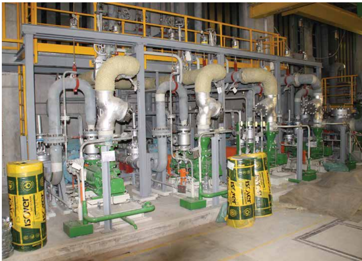
Kondenzatne črpalke nove toplotne postaje 3; foto: Arhiv TEŠ
