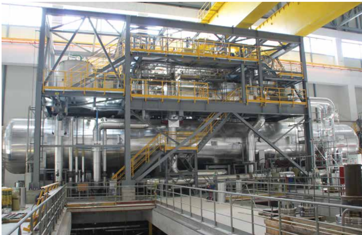
Glavni napajalni rezervoar bloka 6; foto: Arhiv TEŠ
