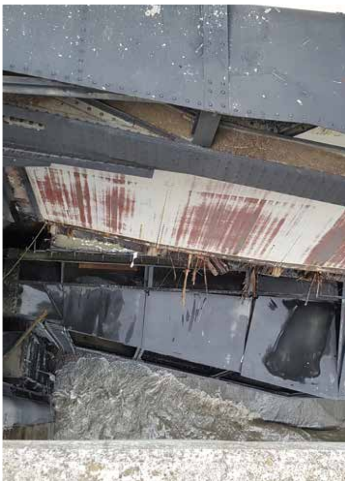
Poškodovana zapornica HE MO; foto: Arhiv DEM
