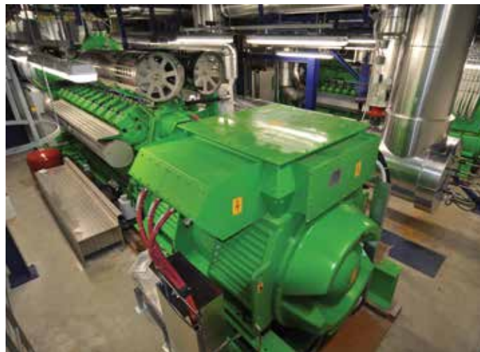
Oba kogeneracijska motorja v kotlovnici Planina; foto: Arhiv HSE
