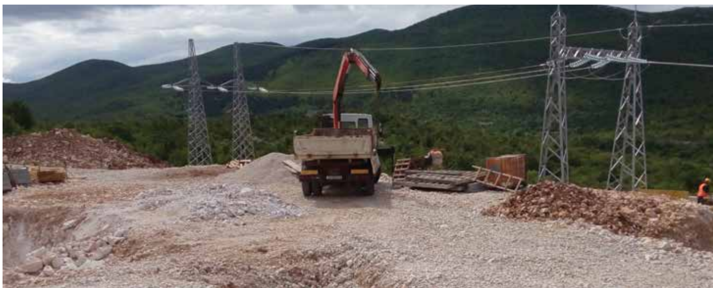
Pogled na mesto vključitve v 110 kV DV Bilice-Trogir (slikano z lokacije predvidenega 110 kV stikališča); foto: Arhiv HSE Invest
