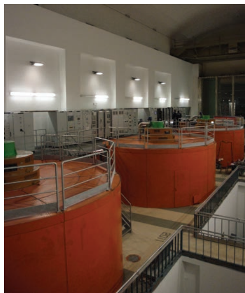
HE Doblar 1 bo po sedmih desetletjih obratovanja prenovljena in pripravljena na naslednja desetletja zanesljivega obratovanja; foto: Arhiv SENG
